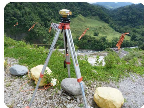
Traslado de punto al área de las oficinas de EISA presa Monte- Lirio
